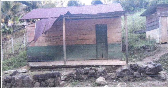
Foto 1: Ampliación de cocina por desprendimiento de tablas de madera
