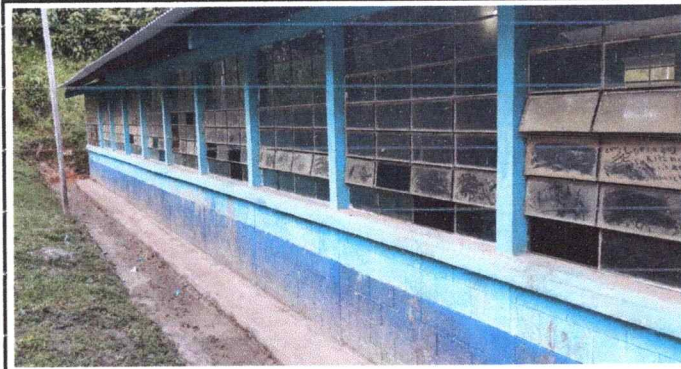
Foto 3: Ventana de vidrio en mal estado
