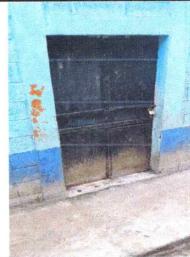
Foto 4: Deterioro de las puertas del establecimiento
